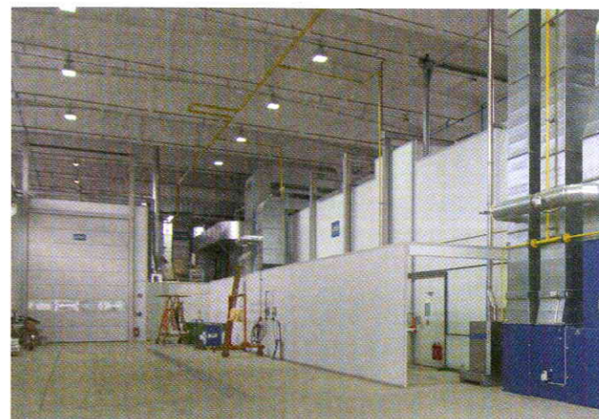
Reinigen, Vorbereiten, Lackieren und Trocknen in einer Linie erfolgt energiesparend durch den Einsatz von Gasflächenbrenner, Wärmerückgewinnung, sektionaler Belüftung der Lackierkabine und Frequenzumformer.
